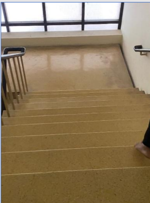
Posisi Tangga Cukup Curam dan Pembatas yang agak renggang
