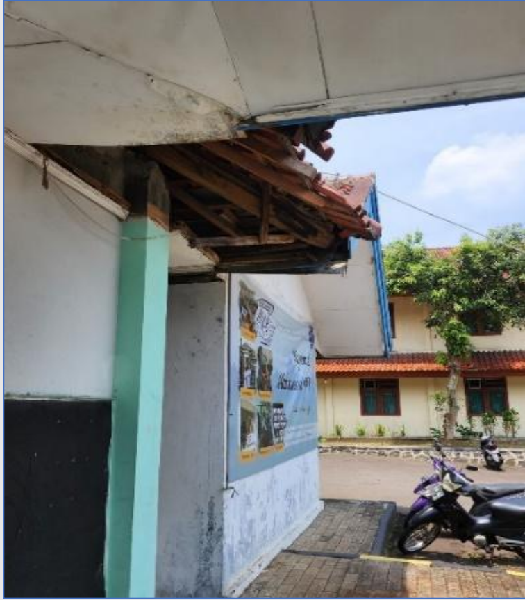
Kondisi Atas Kantin Asrama Putra
