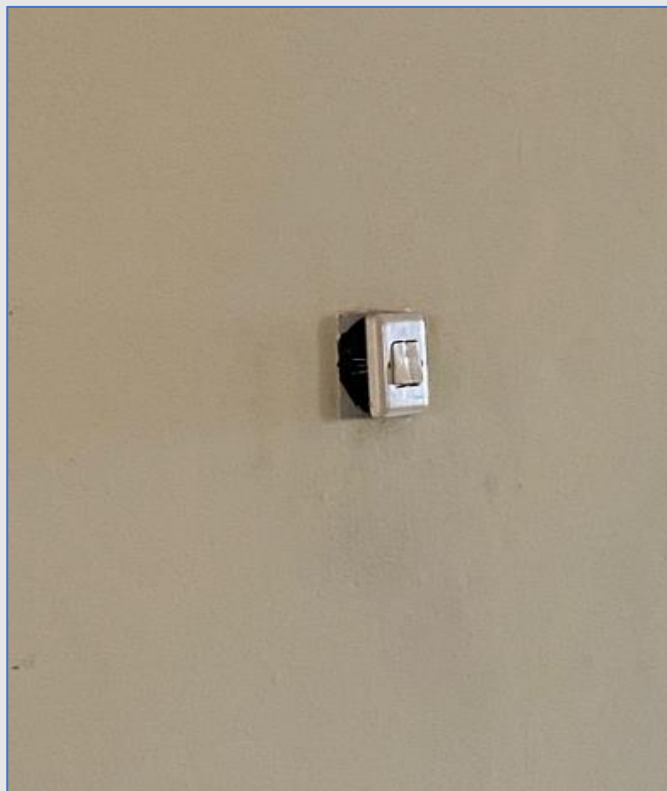
Stop Kontak Lampu yang sudah renggang
